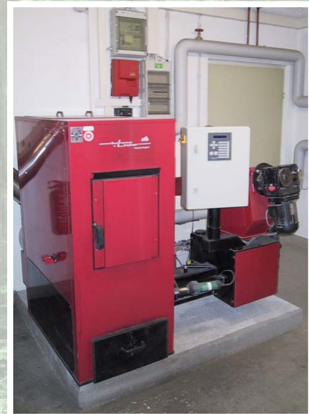
Pelletsessel mit Förderanlage(rechts)
