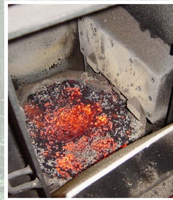
Pelletsessel Einsicht Brennraum
