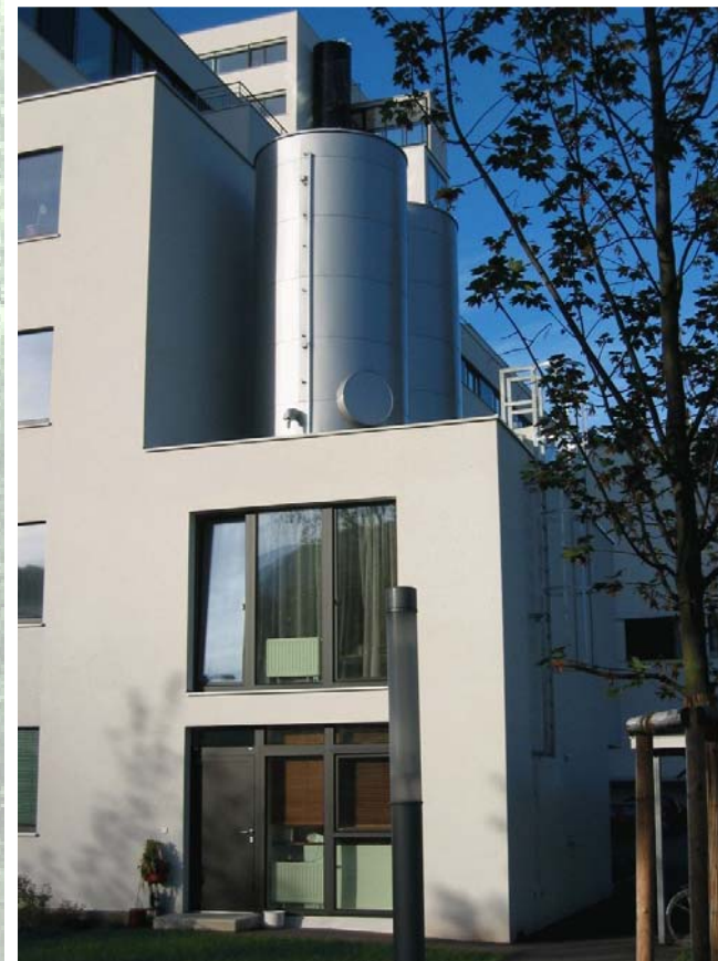
außenliegende Pufferspeicher (2x15.000lt.)
