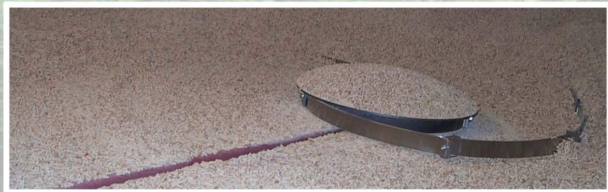
Pellets Lagerraum mit automatischer Fördereinrichtung
