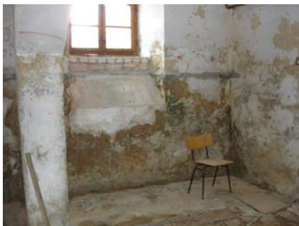
Feuchteschäden und Ausblühungen im Souterrain der Mittelschule
