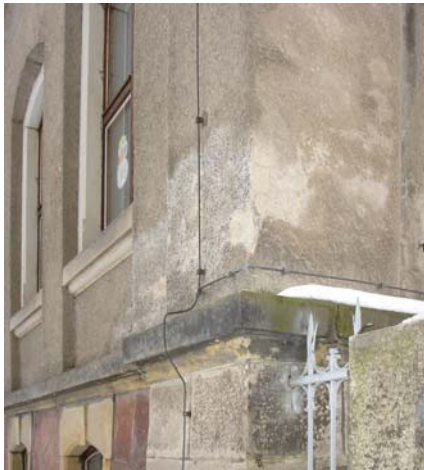
Schäden an der Fassade der Mittelschule
